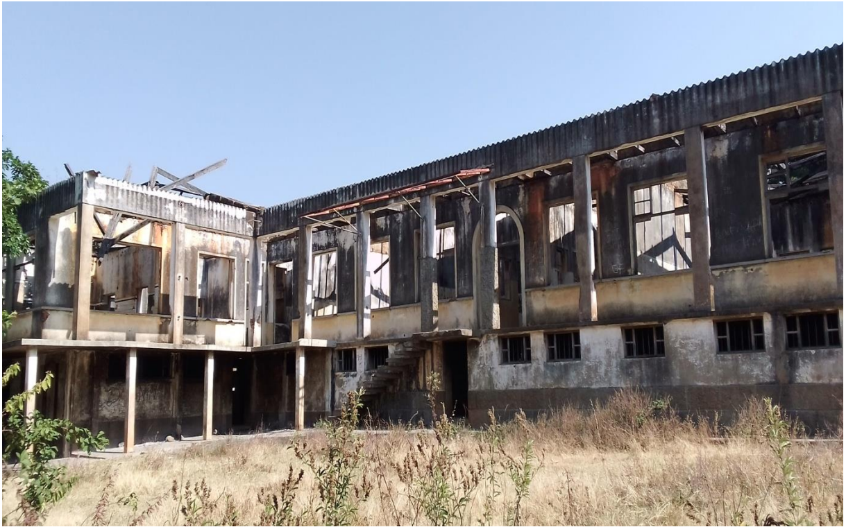
Imagem3: escombros que representam o antigo Hospital da Missão que atendia toda a região centro e sul de Angola. Era considerado o Hospital mais apetrechado e um dos melhores em África. (tirada pela autora).
